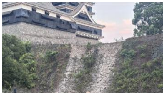
平左衛門丸石垣(石垣崩落)
