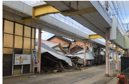
八代本町アーケード(店舗崩壊)
