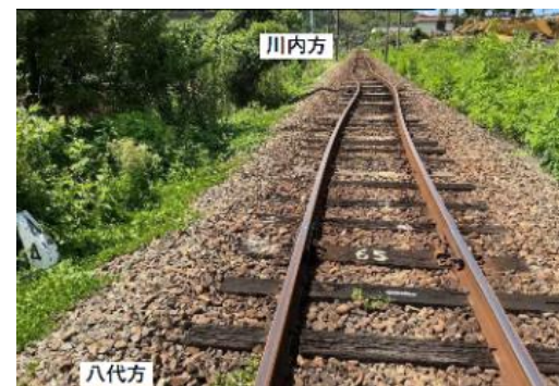
肥薩おれんじ鉄道(線路変形)
