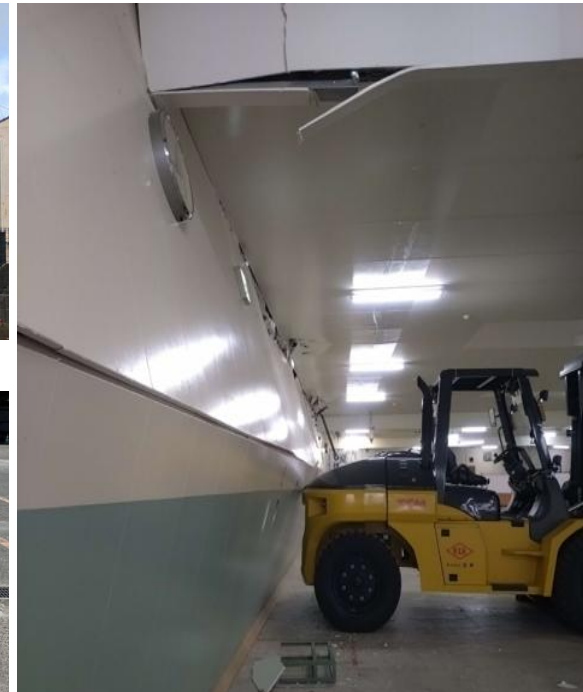
龍田紡績(内部破損)
