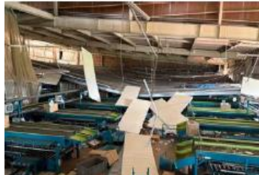
JA熊本経済連施設(施設崩壊)
