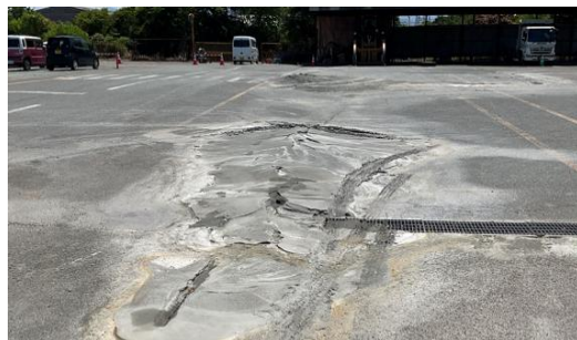
日本通運駐車場(液状化)
