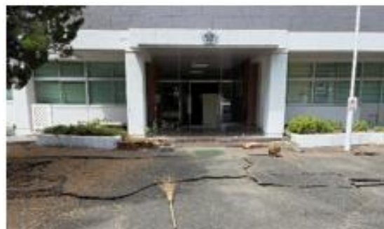
甲佐町立乙女小学校(建物ひび・ズレ)
