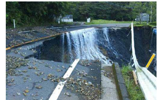
道路の陥没 (主要地方道佐伯津久見線)
