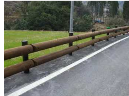
木製ガードレール
